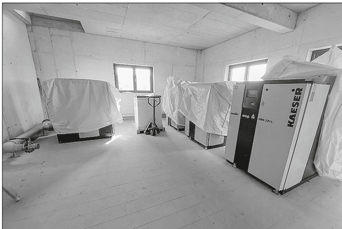
Kompressoren im EG des Maschinengebäudes.
