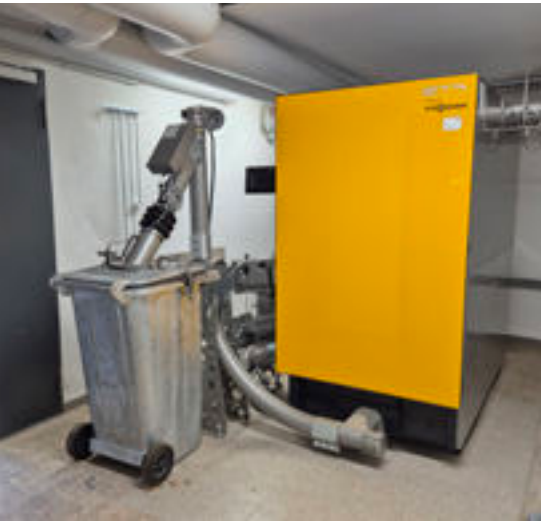
Abbildung 30: Neue Hackschnitzelheizung Landratsamt Ansbach Quelle: Landratsamt Ansbach, 2025
